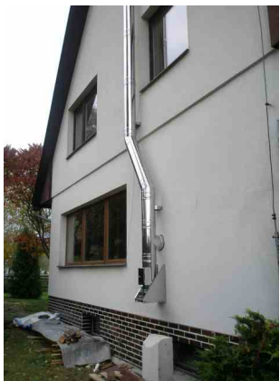
úhyb spalinové cesty
