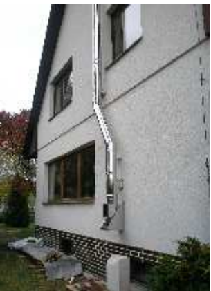
úhyb spalinové cesty
